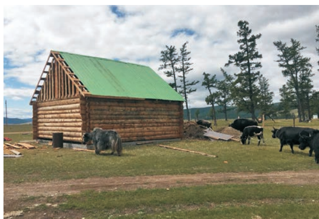
Det første hus blev opført på det dårligt udførte fundament og måtte flyttes.
